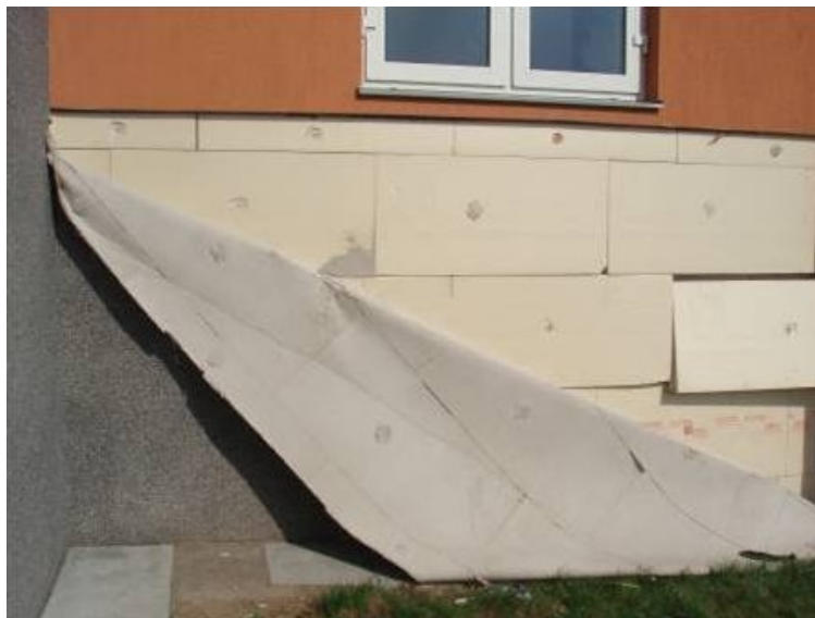
Obr. 3 Příklad destrukce zateplovacího systému v důsledku nedodržení technologického postupu [6]
