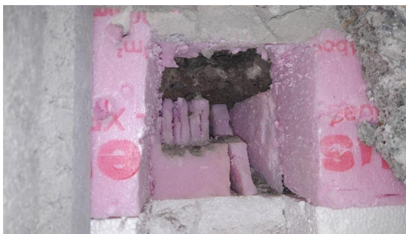
Obr. 5 Tmavý vlhký betón spádovej vrstvy nad XPS polystyrénom (pod povlakovou krytinou) s neprípustnou vlhkosťou
