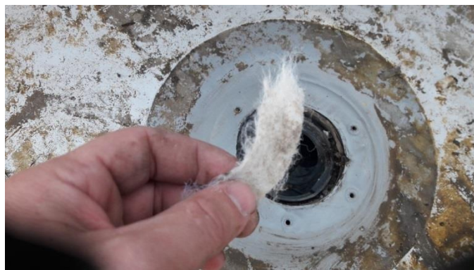
Obr. 6 Nedostatočná plošná hmotnosť separačnej geotextílie medzi betónovou mazaninou a mPVC fóliou
