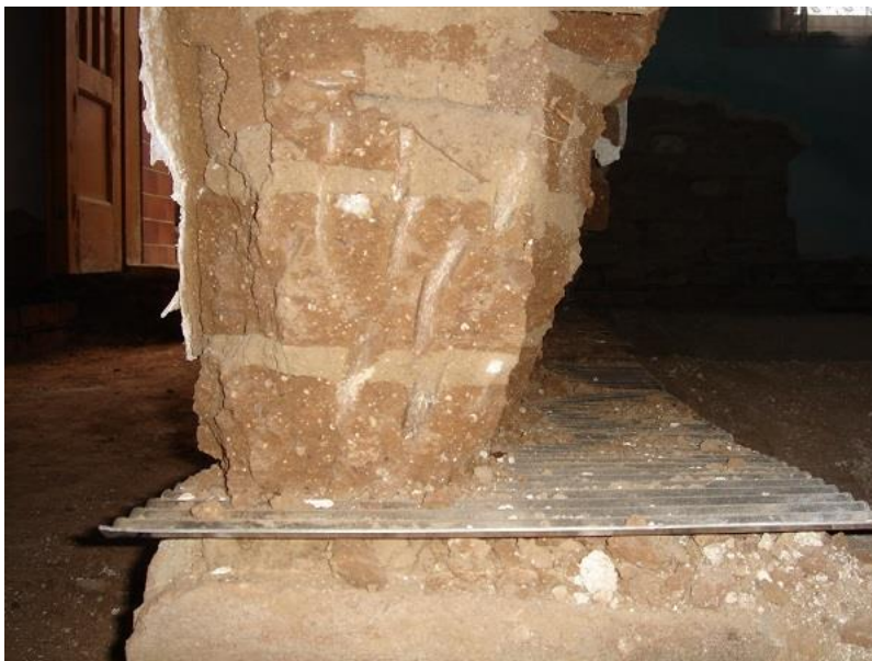
Obr. 4 Příklad nevhodně zvolené technologie při dodatečné izolaci zdiva proti vlhkosti [7]
