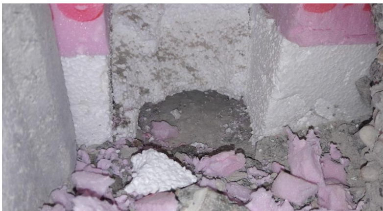
Obr. 4 Chýbajúca parozábrana medzi stropnou dosku a EPS polystyrénom
