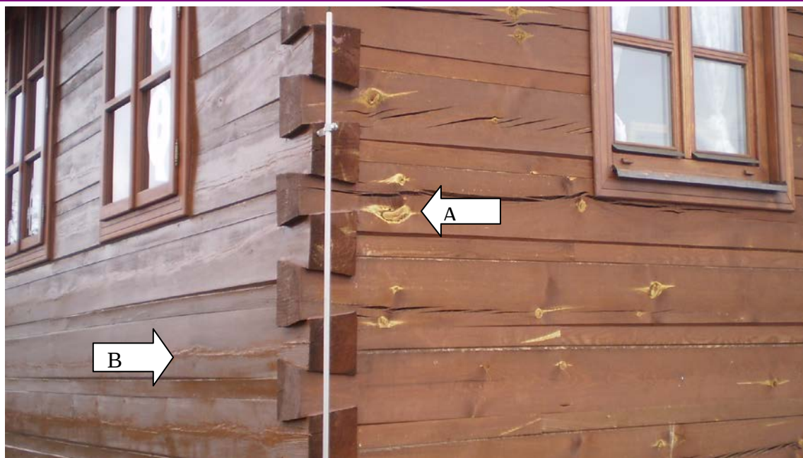
Obr. 4 Pigmentace a výsušné trhliny opravené silikonem [5]
