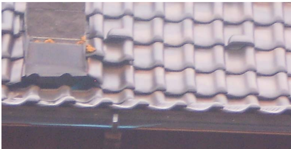
Obr. 6 Mezera mezi střešní krytinou a oplechováním komínu[5]
