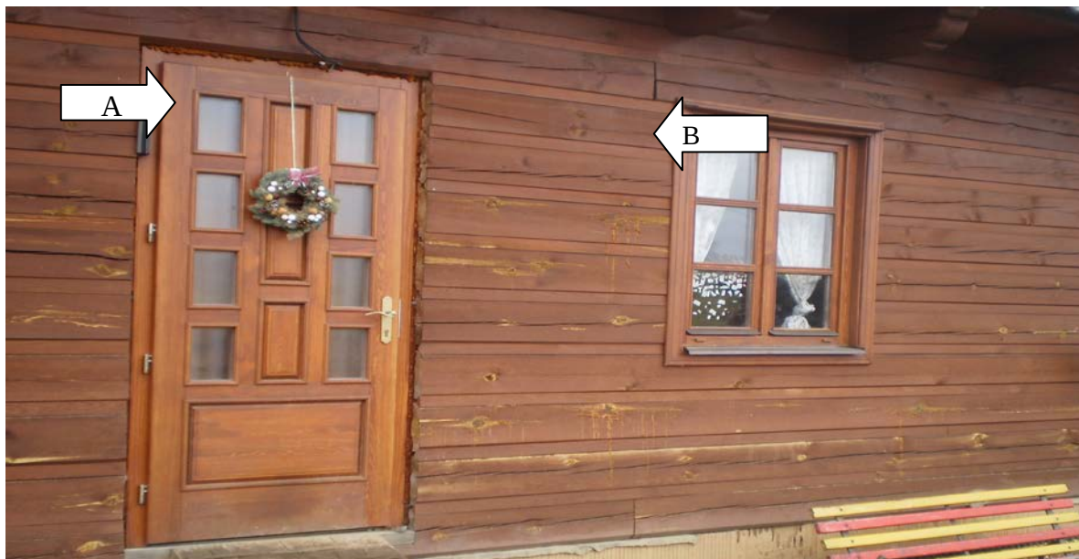
Obr. 5 Izolování zárubní PUR pěnou a nevhodně osazený překladový trám[5]
